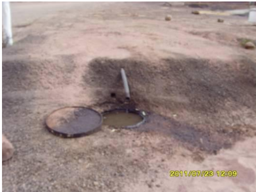
Ilustración 9 – Lavadero de equipos y lugar para cambio de lubricantes sin sistema adecuado para la separación de grasas y aceite. Se observa entorno contaminado
