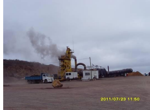
Ilustración 4 – Planta de asfalto en plena producción de mezcla asfáltica
