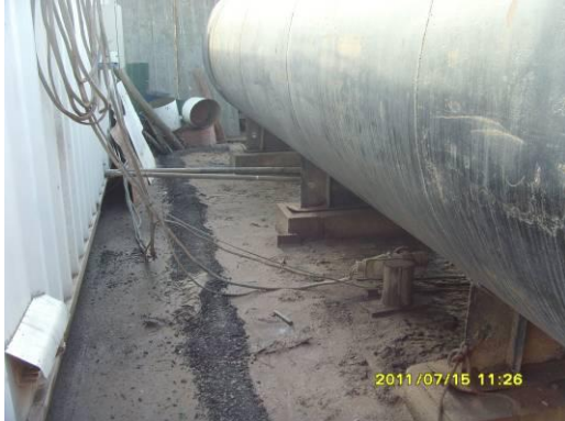
Ilustración 3 – Tanque de combustible con dique muy pequeño de contención de derrames
