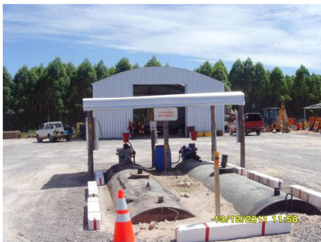
Ilustración 9: Tanques de combustible semienterrados sin dique de protección contra derrames
