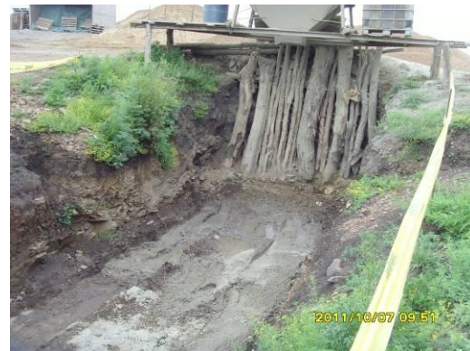
Ilustración 12: Planta de hormigón y lugar de carga del camión
