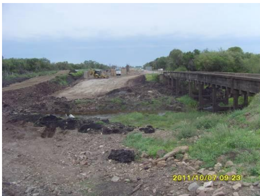
Ilustración 5: Obras del terraplén de acceso al nuevo puente y nuevo desvío para maquinaria pesada
