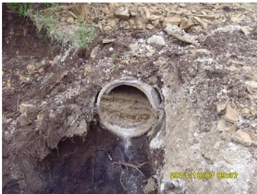
Ilustración 11: Caño de hormigón casi sin luz que comunica el sedimentador primario del secundario
