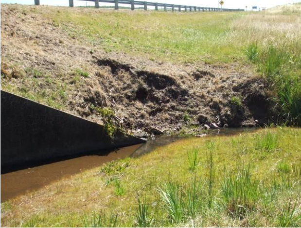
Ilustración 2 - Cunetas sin mantenimiento
