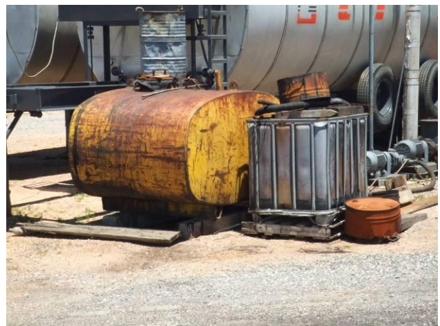
Ilustración 7 - Tanques de combustible sin contención
