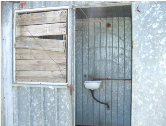
Ilustración 14 - Baño sin ventilación
