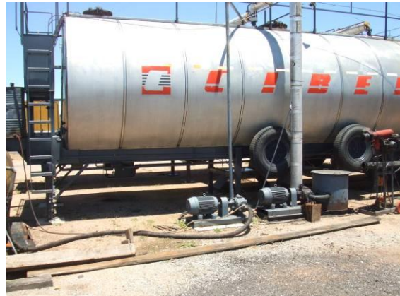
Ilustración 15 - Tanque de mezcla asfáltica sin contención
