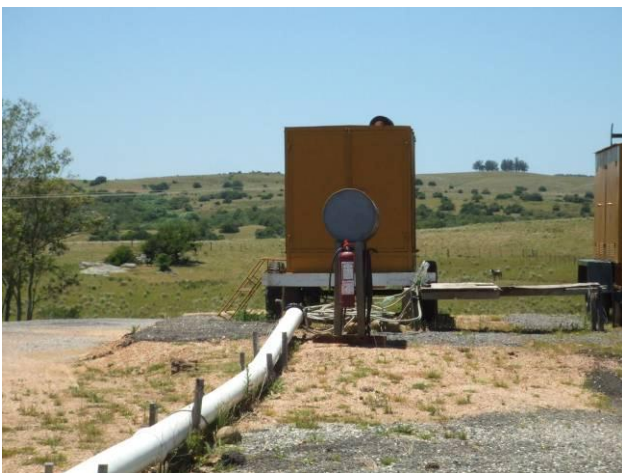
Ilustración 12 - Tanque de combustible sin contención
