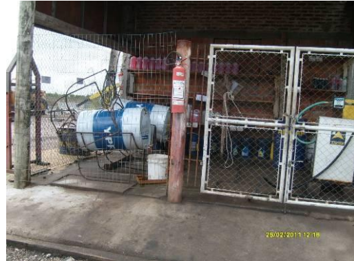
Ilustración 11 - Depósito de tambores con lubricantes con piso de hormigón con pendiente hacia el terreno, sin contención ante derrames
