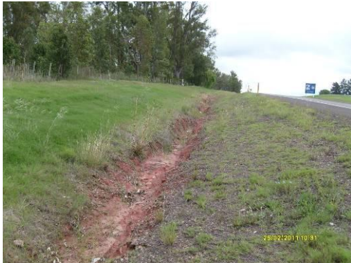
Ilustración 18 - Cuneta con un proceso de erosión activa
