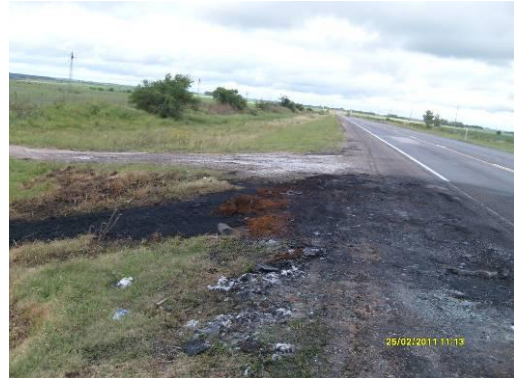
Ilustración 17 - Residuos de cubiertas quemadas y daños al pavimento por incendio de vehículo
