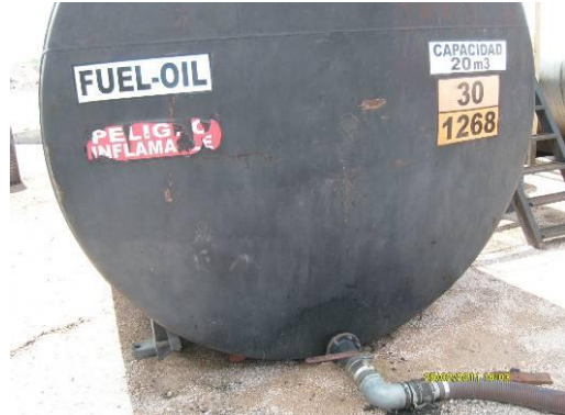
Ilustración 7- Depósito de fueloil sin protección contra derrames
