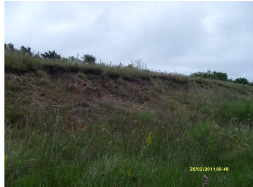
Ilustración 19 - Taludes con erosión activa
