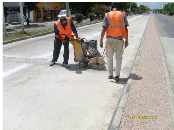
Ilustración 14 -- Cortando pavimento para realización de juntas, sin usar cascos
