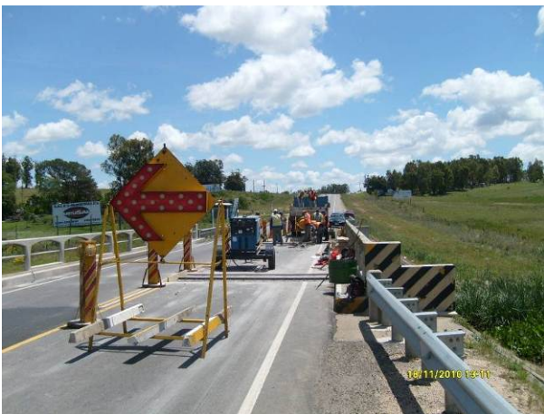
Ilustración 13 - Trabajos sobre puente de la Cañada del Cerro de la RN Nº 5, sin usar cascos
