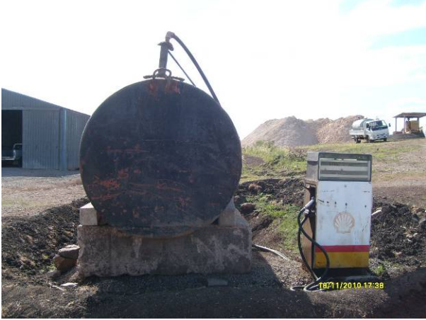
Ilustración 5 – Tanque de combustible con obra de contención de derrames pero sin impermeabilización
