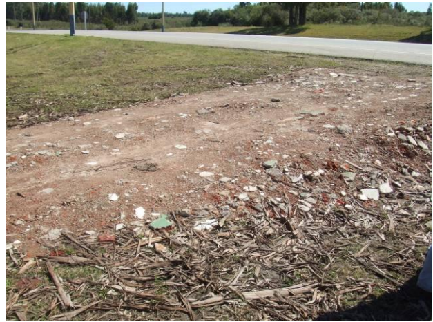
Ilustración 22 – Cuneta anulada por escombros
