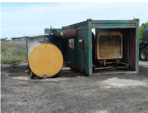
Ilustración 25 - Planta Asfáltica generador y tanque sin contención
