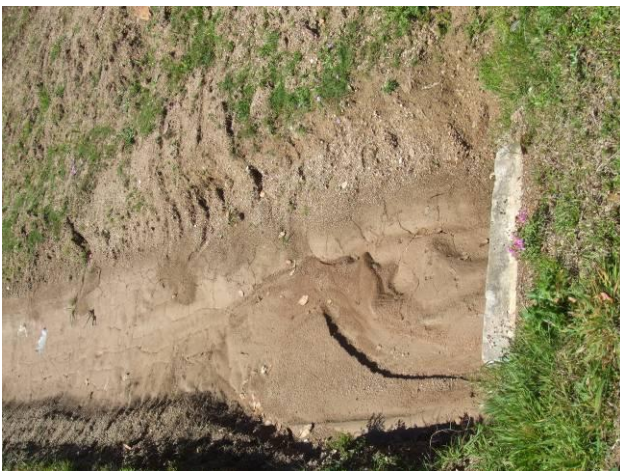
Ilustración 15 - Erosión y arrastres
