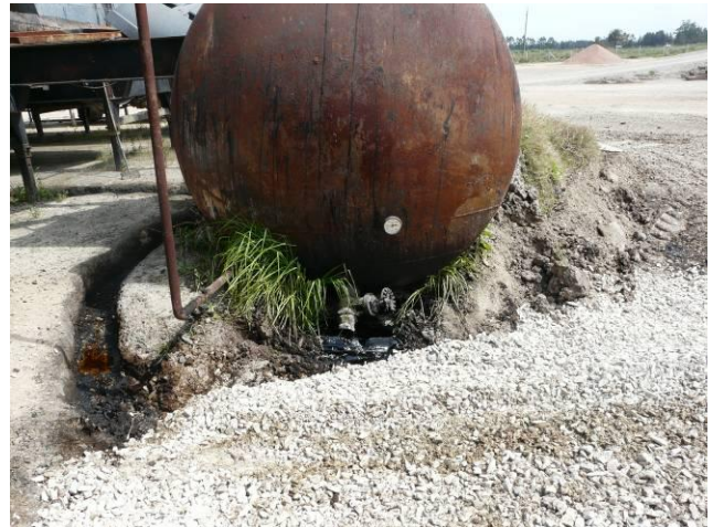
Ilustración 20 - Planta Asfáltica tanque sin medida de contención
