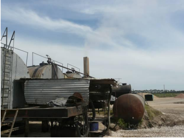
Ilustración 5 – Tanques de combustible en la Planta de Asfalto
