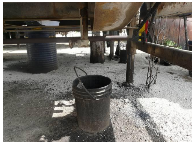
Ilustración 24 – Planta Asfáltica tanques de combustible sin contención
