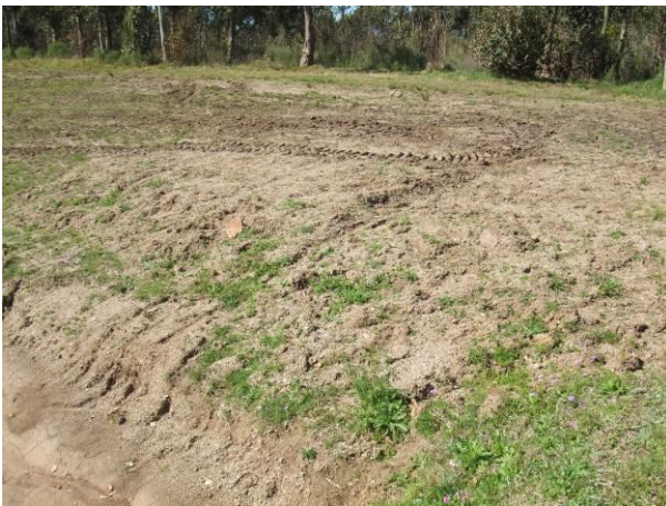
Ilustración 13 - Erosión en banquina
