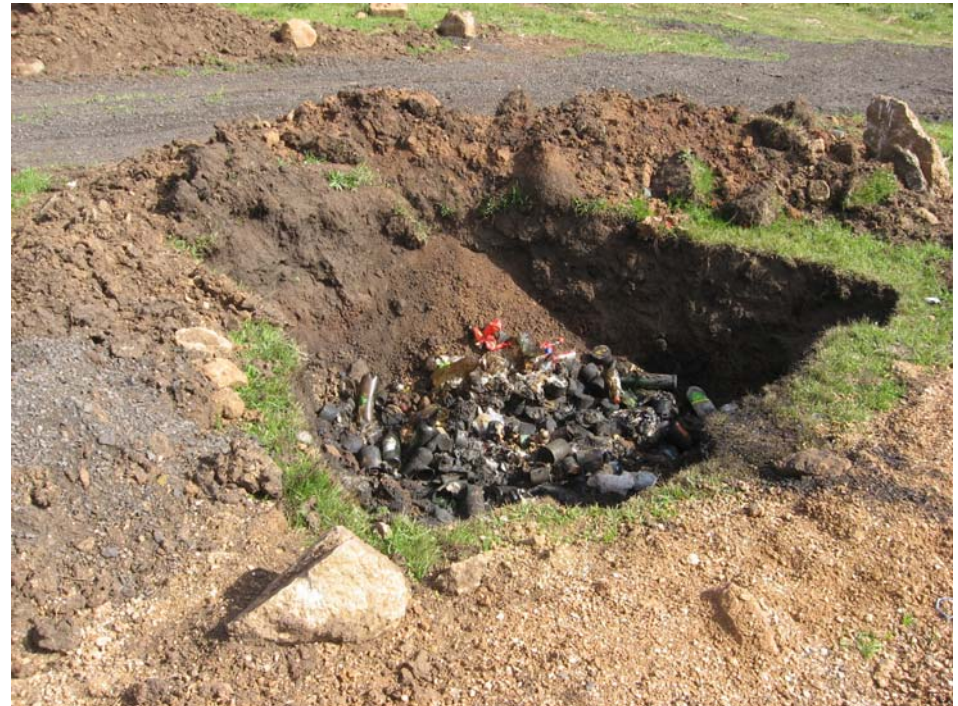
Disposición de residuos en obrador con signos de quema
