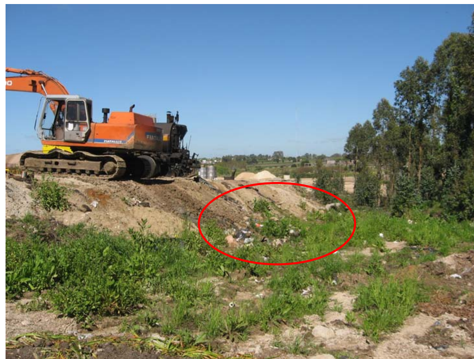
Vertedero de residuos en obrador de Brasilia Guaiba
