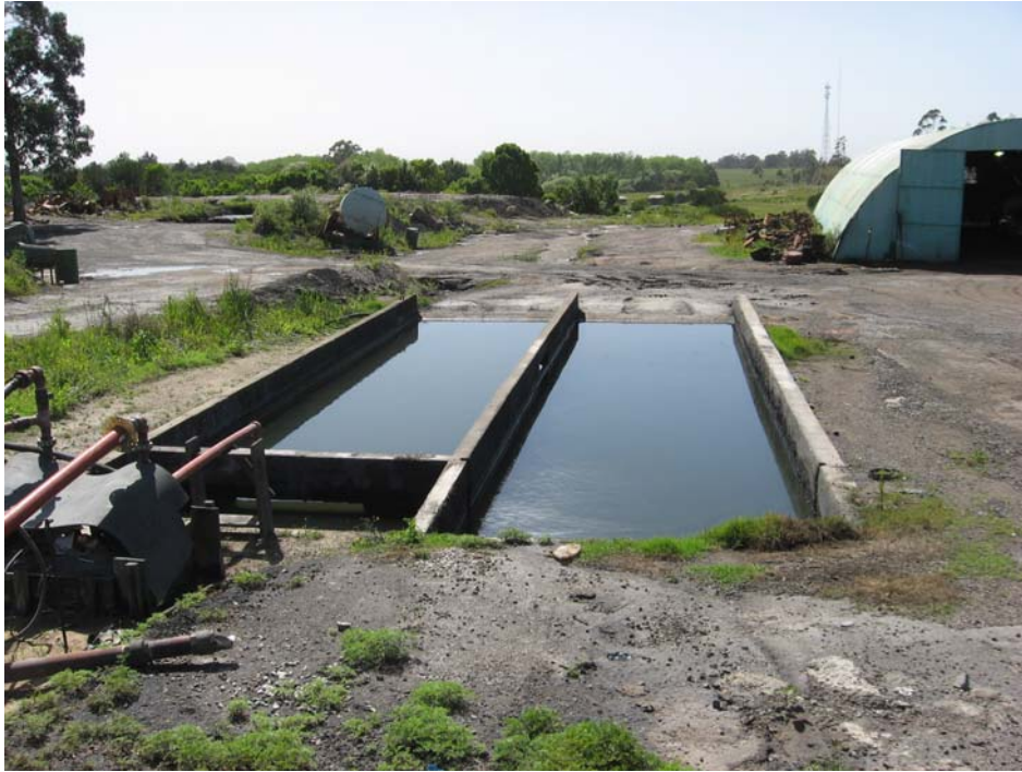
Piletas de tratamiento de emisiones de material particulado
