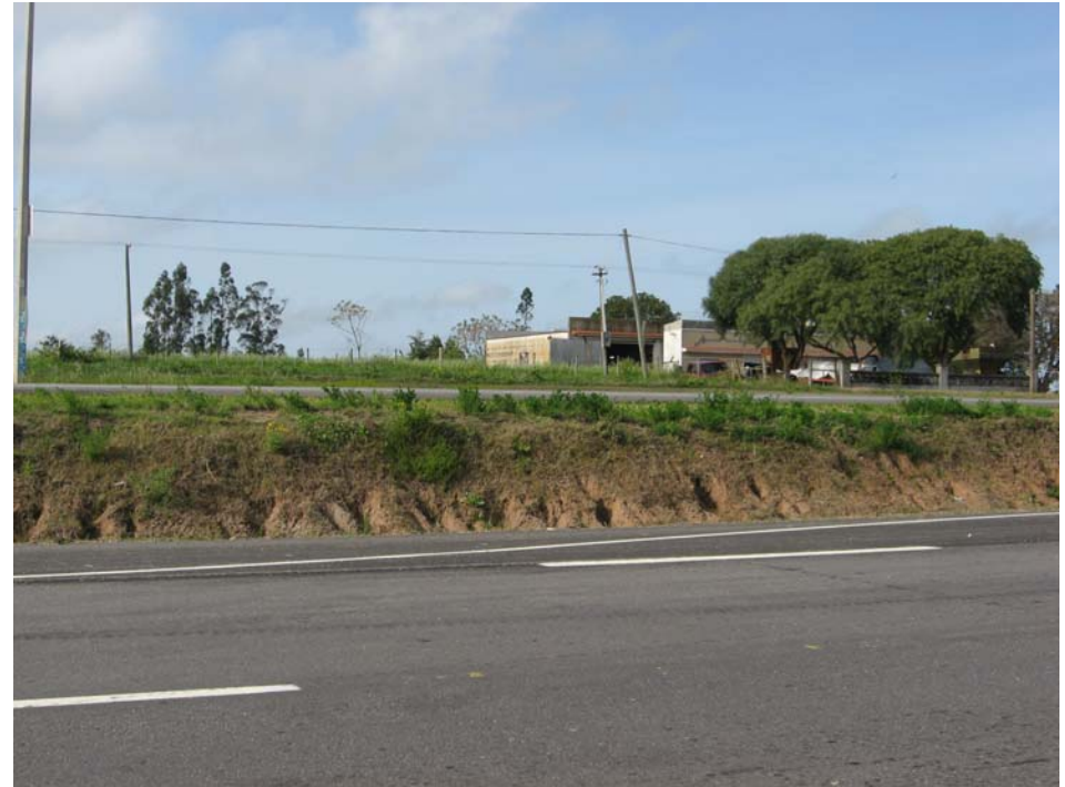
Erosión en taludes
