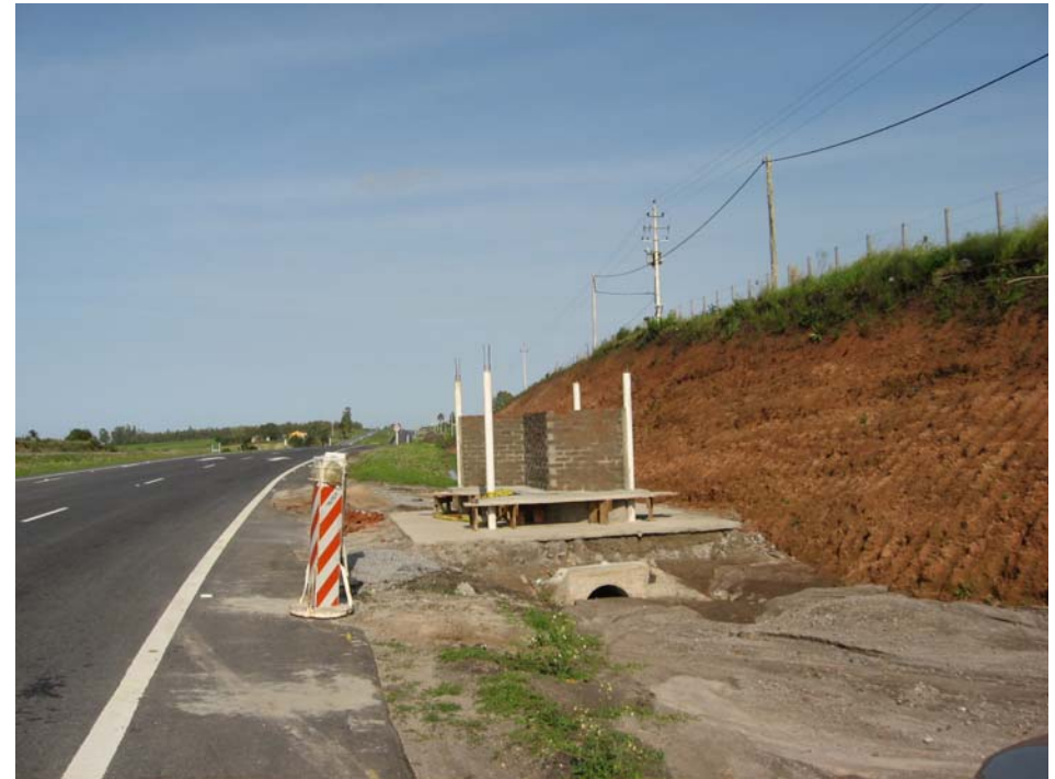
Parada en construcción con drenaje obstruido
