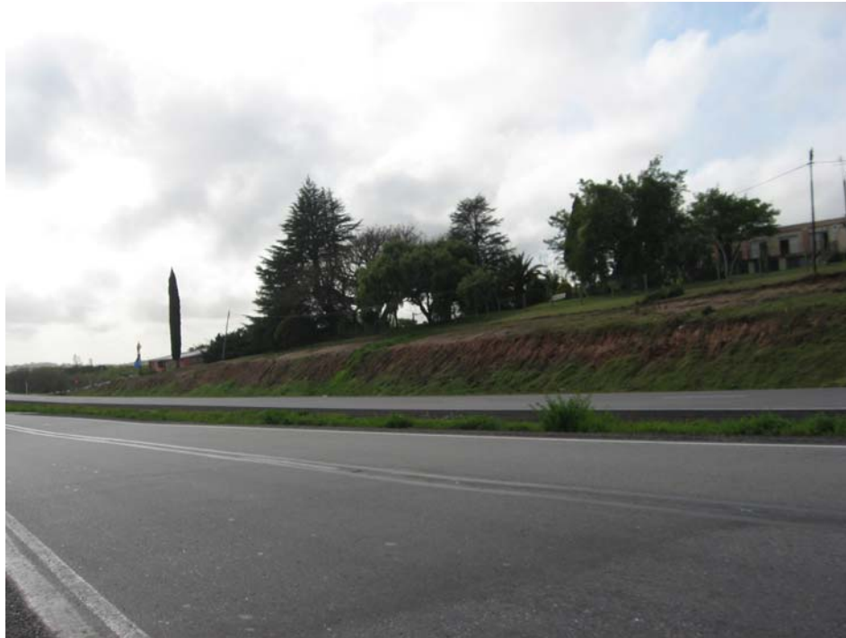
Erosión en taludes
