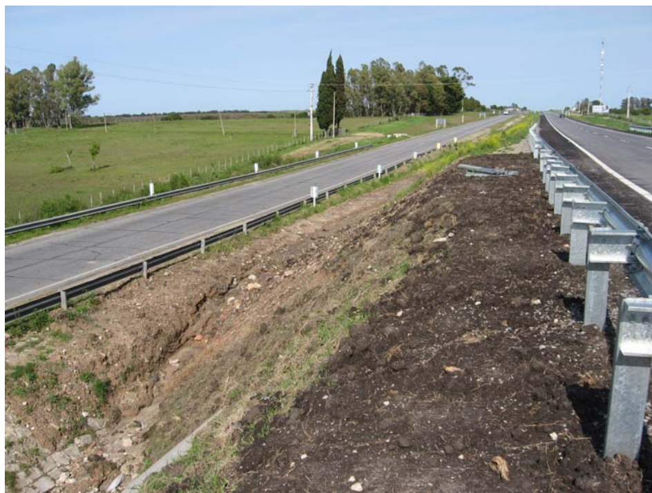
Erosión en taludes
