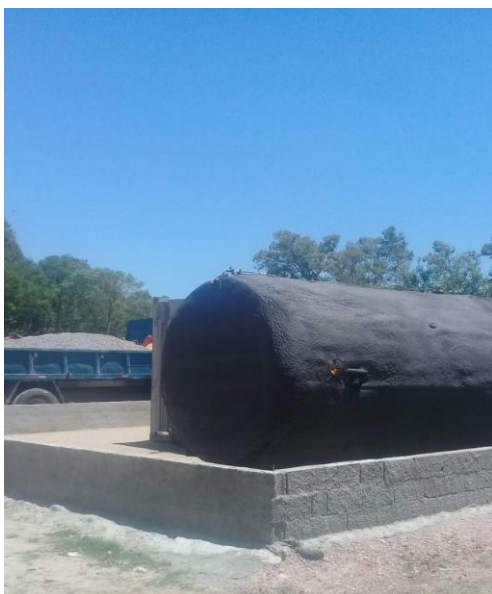
Ilustración 6 – Tanque de almacenamiento de hidrocarburos en campamento DNV.
