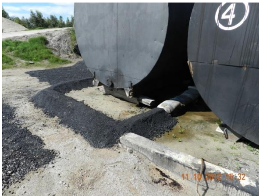
Ilustración 6: Detalle de diques de contención incompletos
