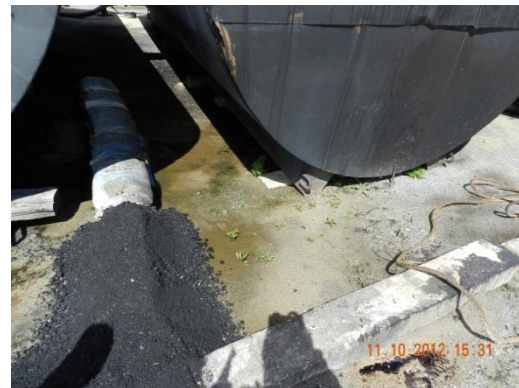
Ilustración 7: Detalle de diques de contención incompletos
